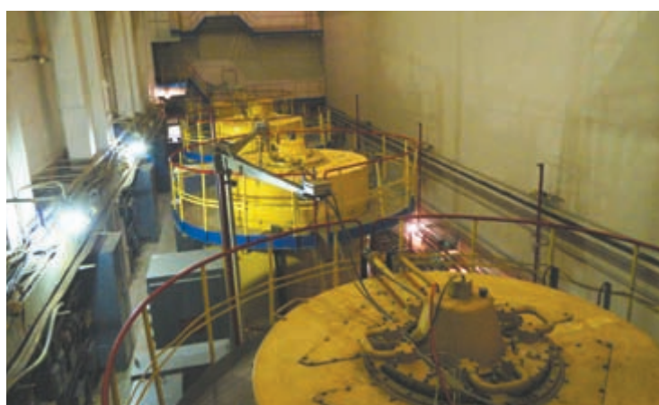
Главные циркуляционные насосы
