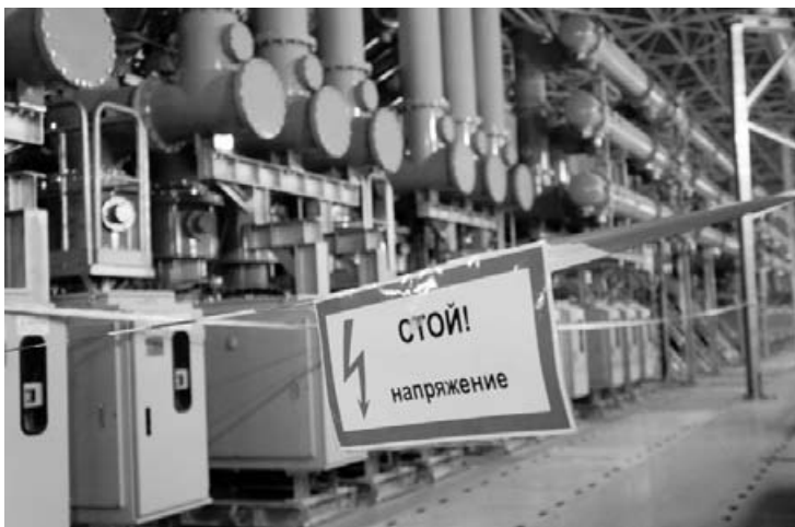
В КРУЭ 330 кВ работать необходимо с осторожностью
