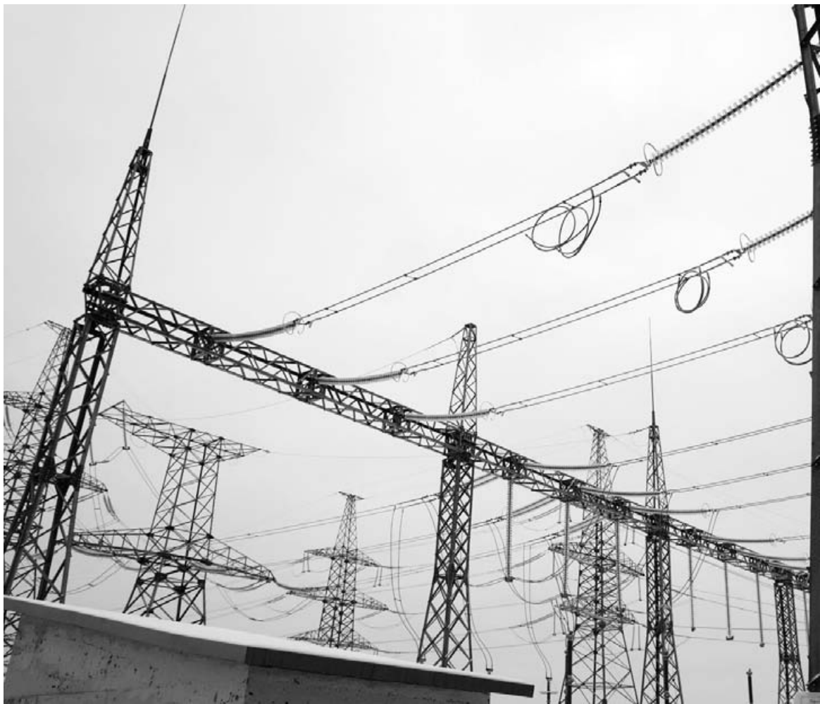
Благодаря комплектному распределительному устройству КРУЭ 330 кВ, электричество
