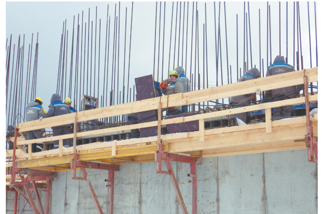
На нулевую отметку выходит и строительство машинного зала, уложена фундаментная плита, идет возведение наружных стен и колонн
