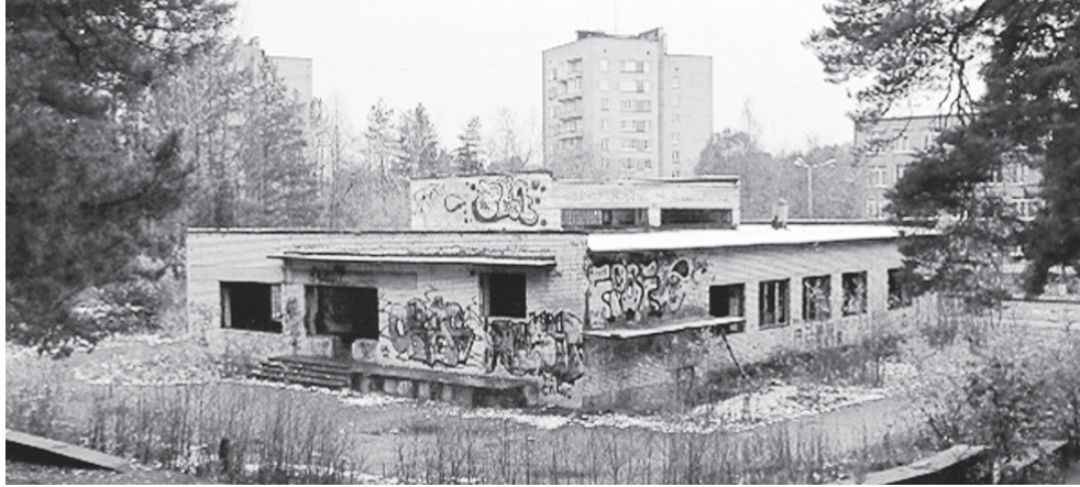
Здание бывшей молочной кухни уже много лет стоит в полуразрушенном состоянии в центре города
