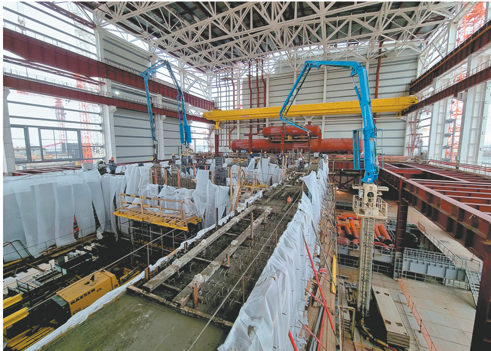
Фундамент турбоагрегата — это действительно максимальная по уровню ответственности и сложности конструкция во всем машинном зале
