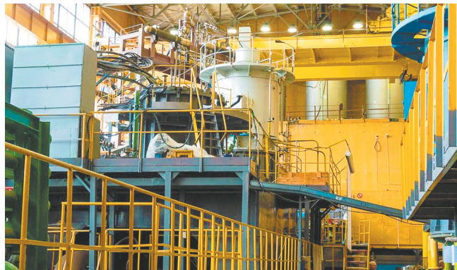
Сейчас в ЦКБМ-2 проходит испытания циркуляционный насос нового поколения, который ждут на АЭС в Беларуси и на станции «Аккую» в Турции
